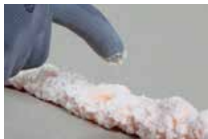
La couche de colle se fissure au contact : trop tôt
